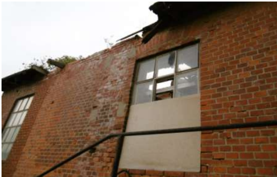
Abbildung 16: Höfingen „Alte Molkerei“: Der Gebäudekomplex an der Nührenbachstraße verfällt zusehends
