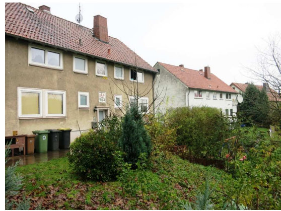
Sanierungsbedürftige Bausubstanz im Bereich der Siedlung Kiffenbrink
